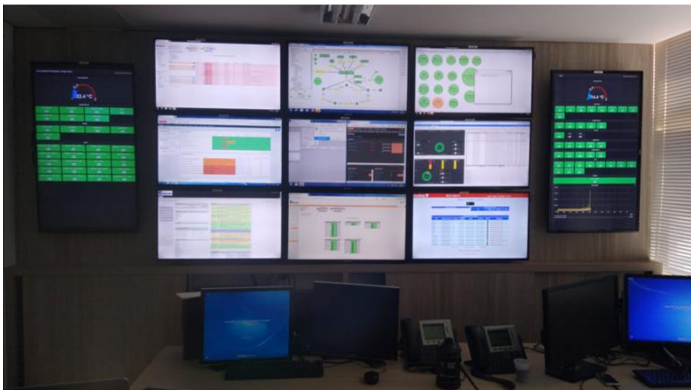
Figura 1 - Infraestrutura do Command Center | NOC - CIMCORP/QINTESS - CT n° 181/2016
