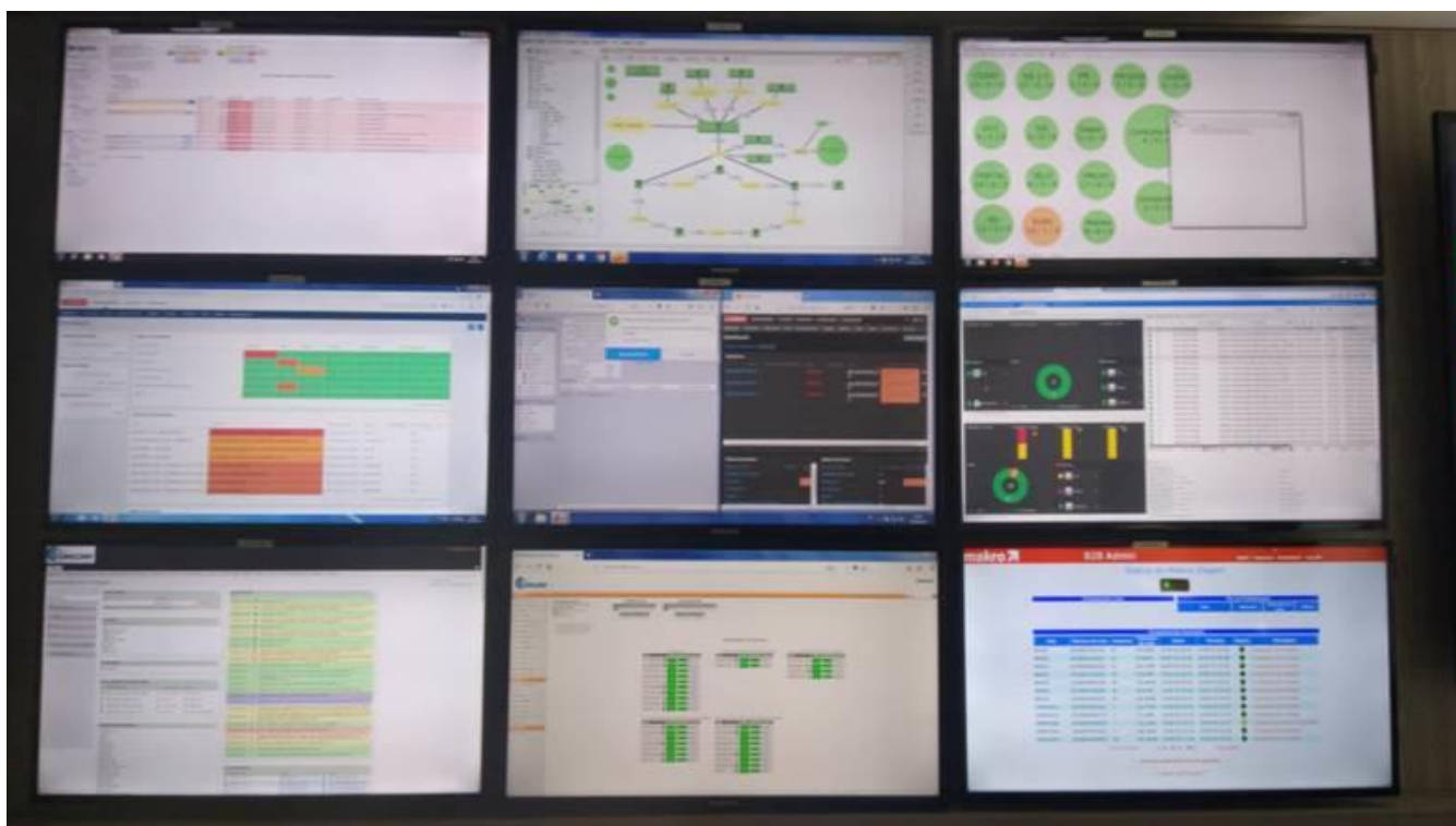
Figura 2 - Infraestrutura do Command Center | NOC - CIMCORP/QINTESS - CT n° 181/2016
